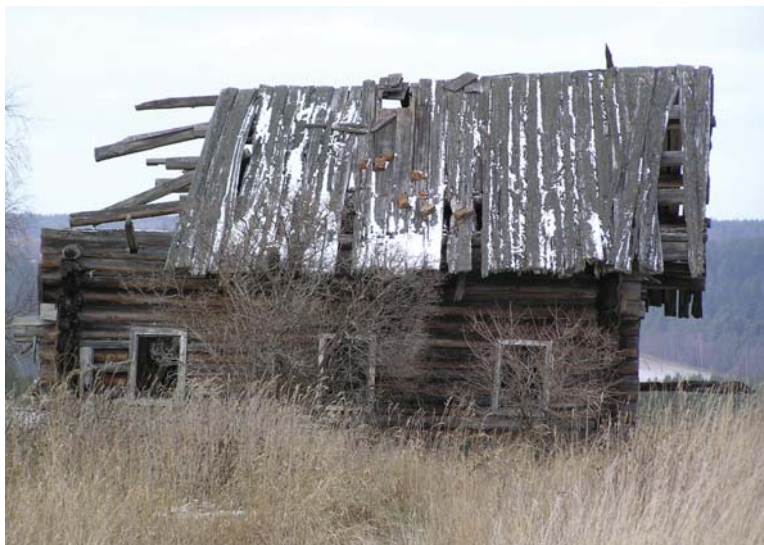
Рис. 2. Разрушенная баня и хозяйстройки
