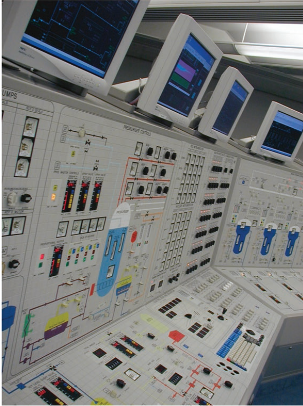
Рис. 1.1 ❖ Часть главного пульта управления водо-водяного реактора (PWR)
