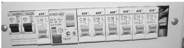
Рис. 10. Автоматические выключатели, установленные в электрошкафу (щитке)
