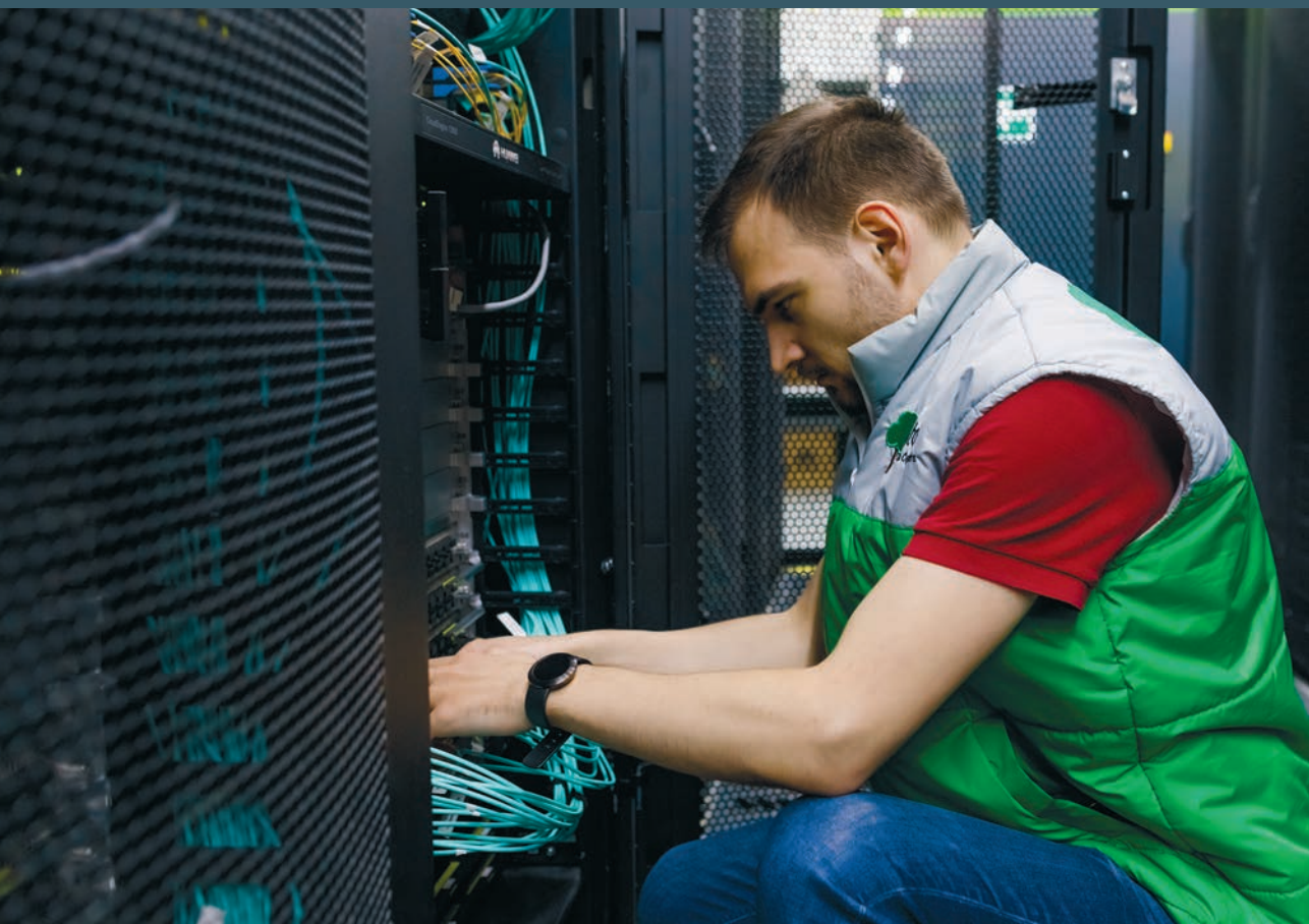
Подключение серверного оборудования в датацентре 3data «У8»
