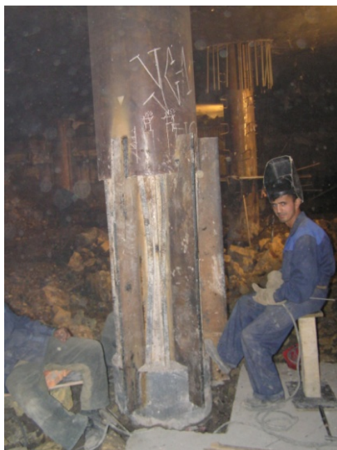
Рис. 2.3. Колонны подземного этажа после откопки грунта на объекте «Ритц-Карлтон», отель категории 5 звезд в Москве по адресу: ул. Тверская, 3
