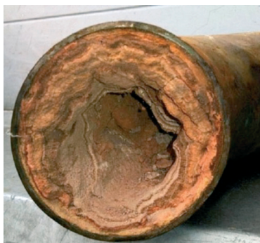
Рис. 1.1. Отложения в напорных коллекторах
