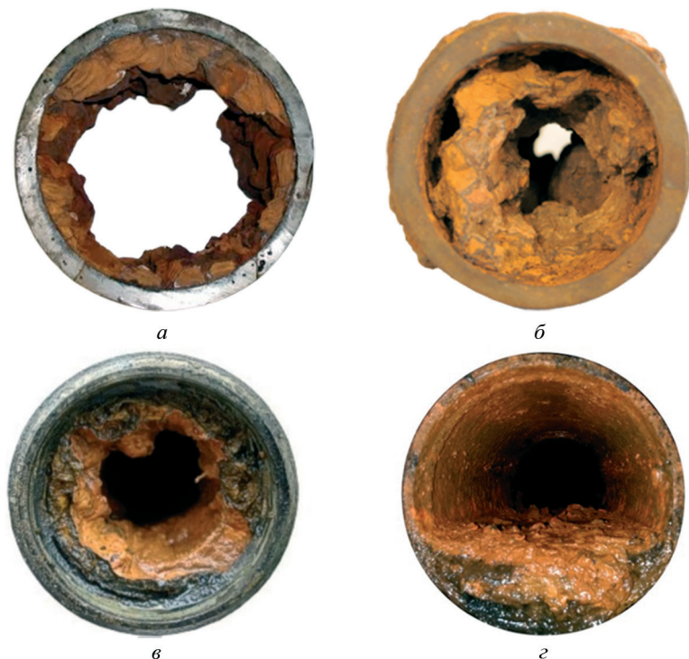
Рис. 1.4. Фрагменты отложений на внутренней поверхности труб: а, б — на стенках металлических труб; в — напорных сетей водоотведения; г — самотечных сетей водоотведения
