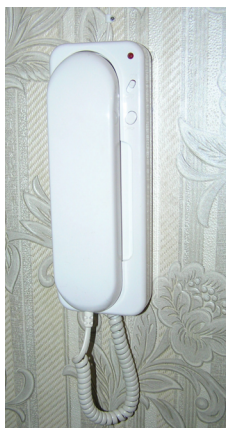
Рис. 1.3. Вид на аудиодомофон, установленный на стене
